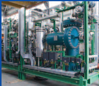
L'impianto SCT-CPO di ENI
