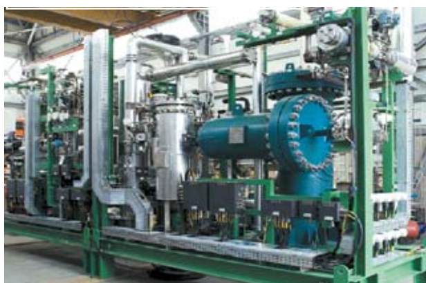
Impianto ENI di produzione idrogeno in situ
